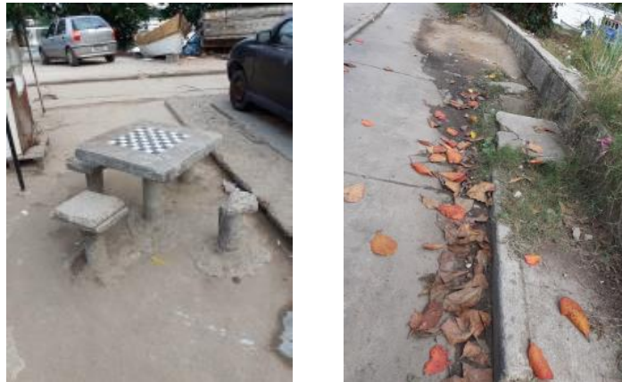
Figura 4. À esquerda, banco de praça danificado e à direita, percurso danificado da ciclovia, observados e registrados durante a visita técnica.
