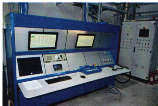
Consolă comandă și control instalatii auxiliare stand
