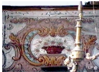
Decorazione esistente sulla parte centrale di una cantoria in legno che sosteneva un organo positivo che già era in pessimo stato di conservazione.
