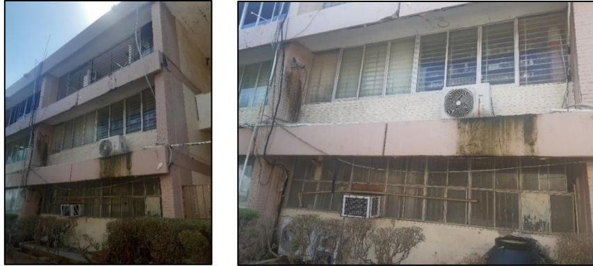
Figuras 7 y 8.- Presencia de humedades en volados posteriores causados por deficientes instalaciones de equipos de aire acondicionado.
