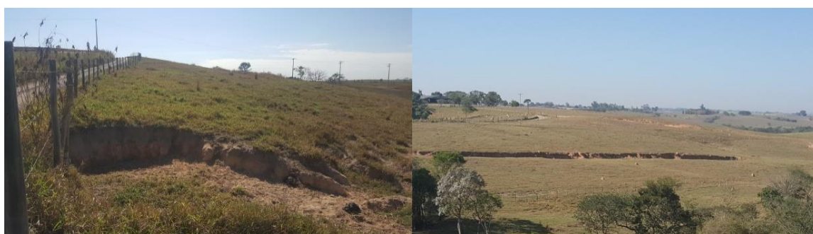
Figura 7.16. Erosões por desvio de água de estrada vicinal em Argissolo Vermelho-Amarelo.
