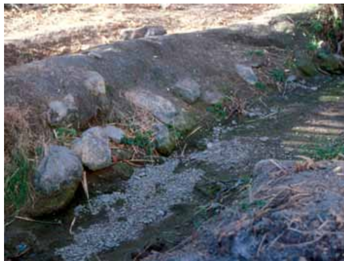
État du canal « La Acequia Real » dans une bonne partie de son parcours avant sa restauration. (Projet Life « Conservation des étangs littoraux d'Adra »).
