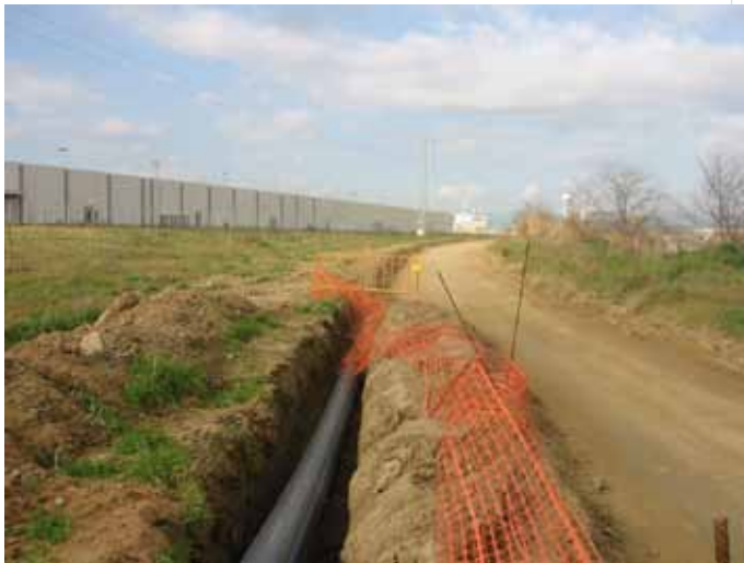
Tuyauteries pour le transport de l'eau
