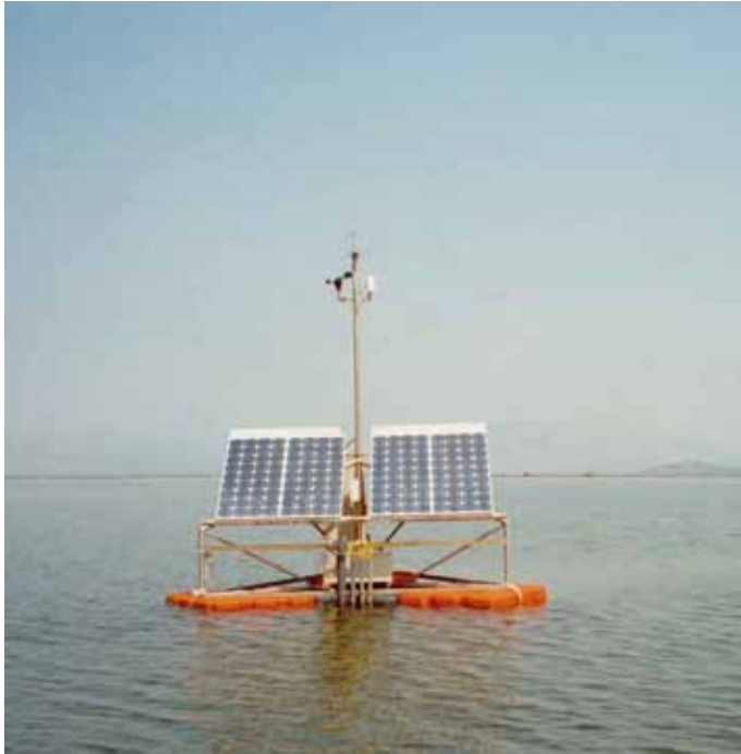
Station automatique de prise d'échantillons de paramètres physico-chimiques dans la lagune de Tsoukalio. Elle fournit des informations essentielles pour déterminer la qualité de l'eau des lagunes et de la rivière Louros
