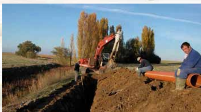
Construction d'un by-pass pour empêcher l'entrée des eaux usées dans la lagune de Boada. Action réalisée à la suite du projet Life-Environnement financé dans son intégralité par la Confédération hydrographique du Duero.
