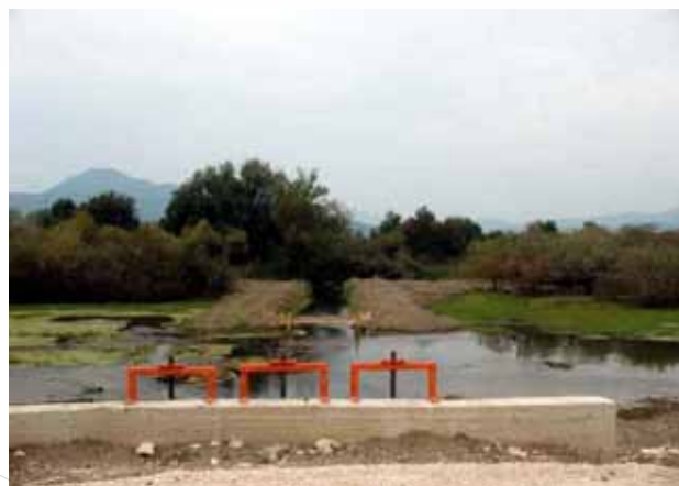
Vannes permettant de réguler les entrées d'eau douce en provenance de la rivière Louros
