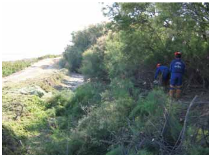
Canal d'irrigation envahi par la végétation
