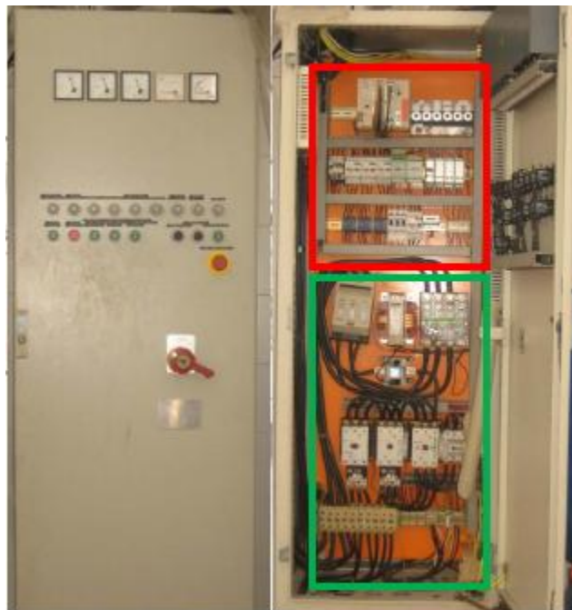
Imagen 6. Tablero de control de la máquina descremadora. Cuadro rojo: Circuito de control. – Cuadro verde: Circuito de potencia
