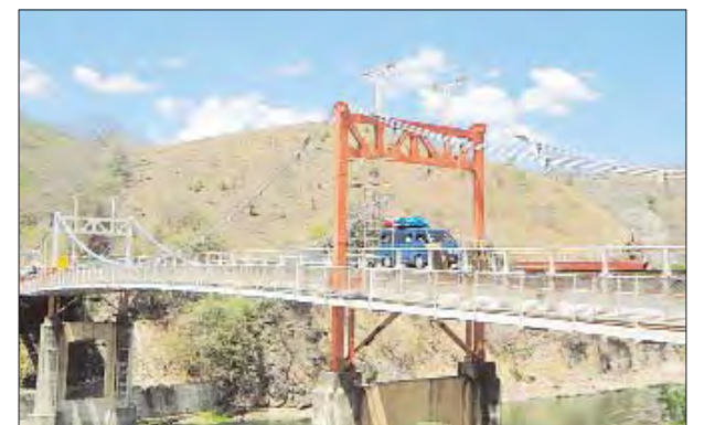
La frontera Las Chinamas ha reducido su actividad desde que el pasado 10 de octubre se dañara el puente. /DEM
