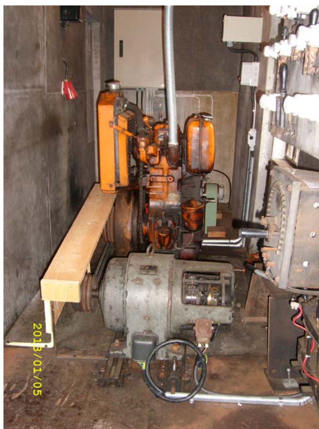
Figur 13 Reservlikströmsgeneratorn kopplad till dieselmotorn i bakgrunden.
