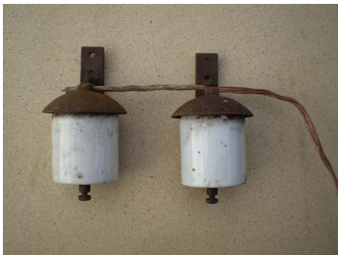
Figur 15 Åskventilerna som satt monterade på noll-ledaren strax söder om kraftstationen på den utgående tvåfaslinjen mot Långserum.
