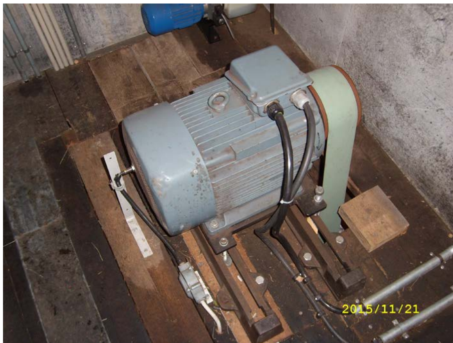
Figur 20 Den nya asynkrona växelströmgeneratorn, fabrikat VEM.
