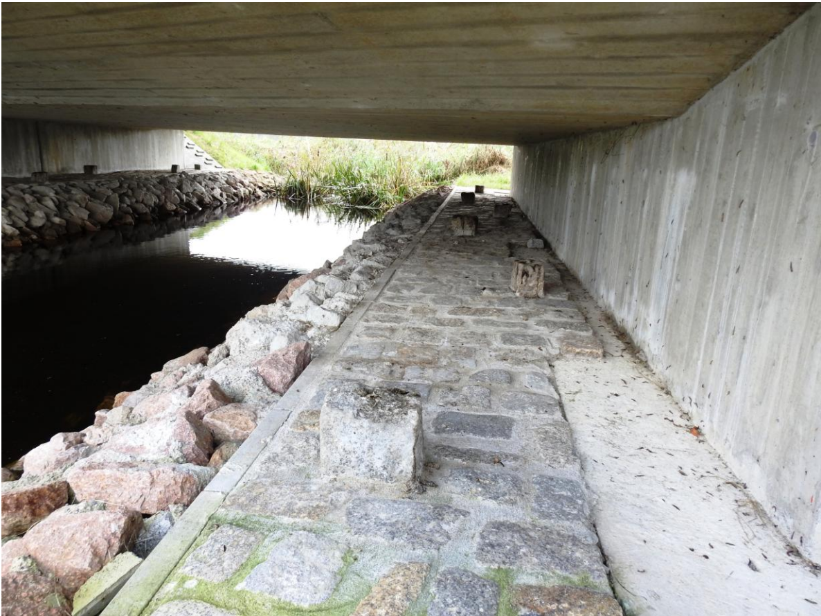
Abb. 7: Schutzmaßnahme am Mühlengraben zwischen Schwerinsburg und Löwitz (M-V)
