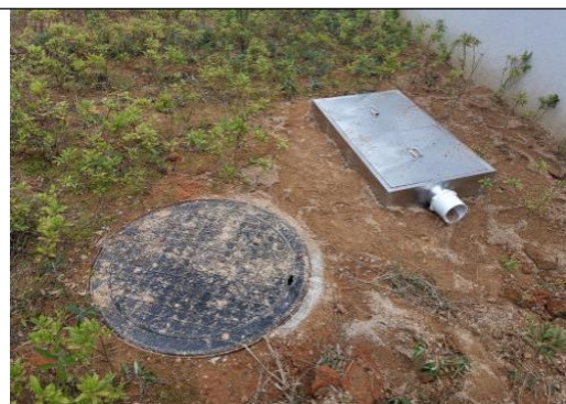
升压站一体化污水处理设施
