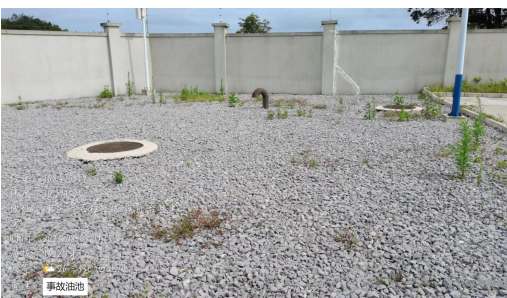
升压站内事故油池
