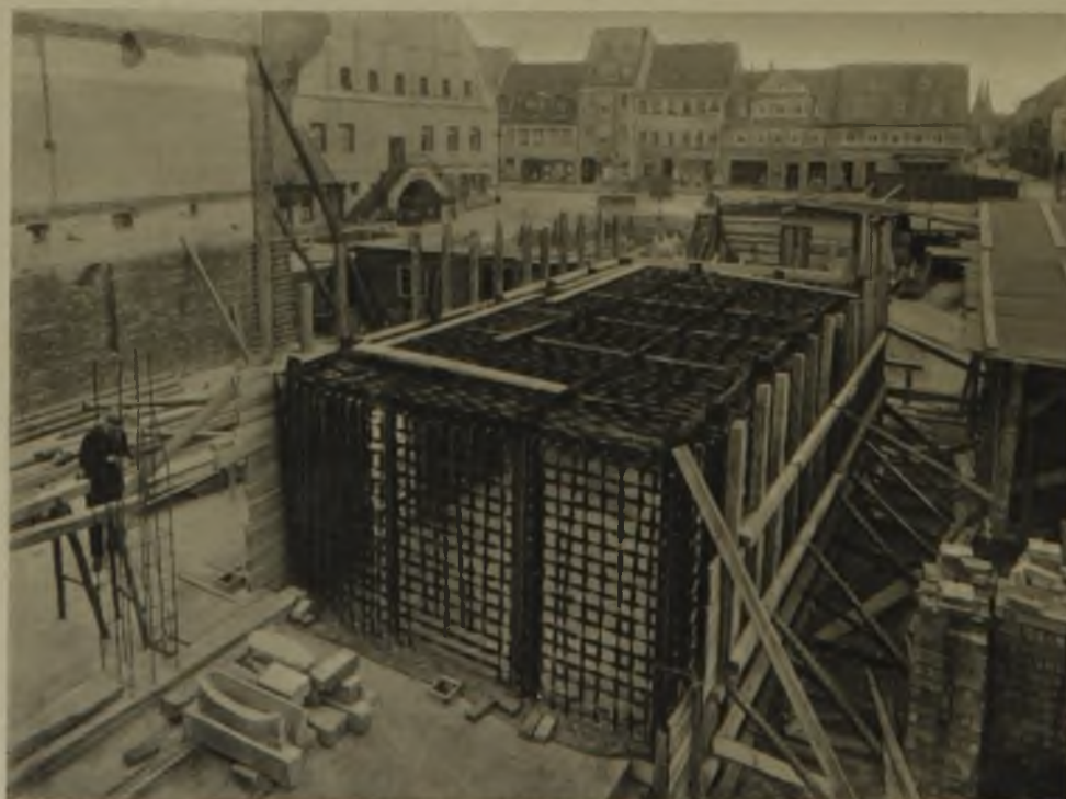
Aufbau der Tresoranlage. Im Hintergrund links das alte Grimmasche Rathaus am Marktplatz. Der Tresor ent- hält Lüftung, Heizung, Telefon und alle Sicherheitsvorkehrun- gen
