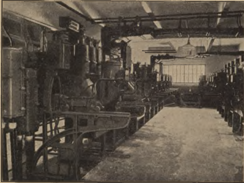
Reyrolle - Schaltanlage 2000 Volt im Schleiferraum der Papierfabrik Weyagmack News Ltd., Three Rivers, Quebec, Kanada.
