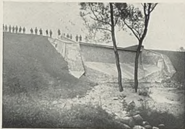
Der wiederhergestellte Staudamm mit Ueberfall. 1925. Bauherr: Mühlengenossenschaft Elbing. Baupolizeiliche Aufsicht: Reg. u. Baurat Siczewski
