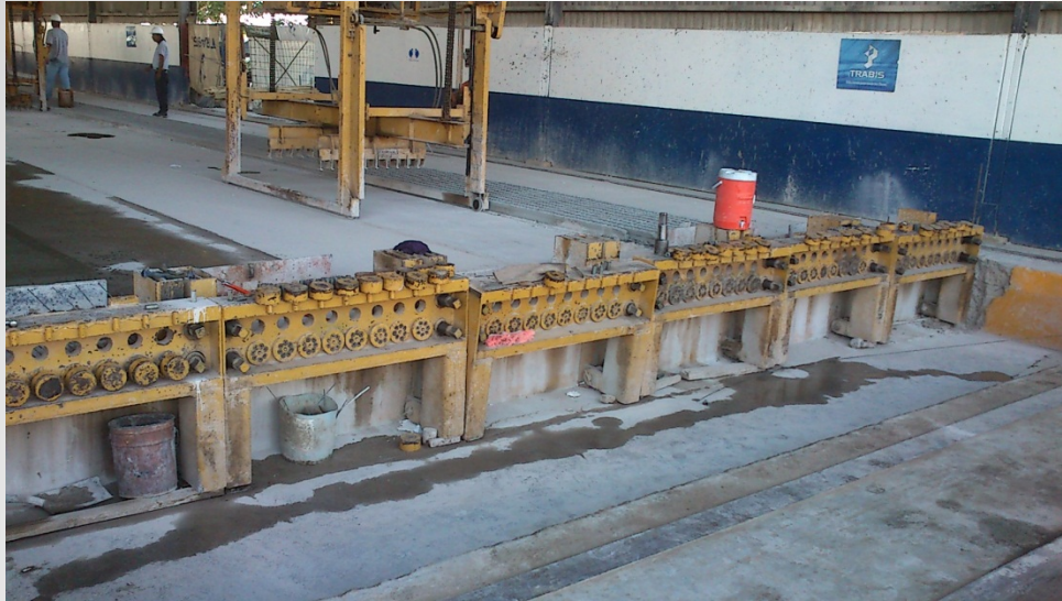
Anclaje activo (gato hidráulico)
