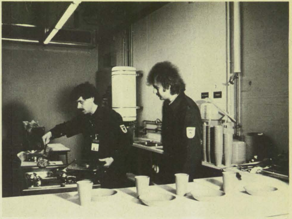
Helfer des Betreuungsdienstes nahmen die Küche der Mehrzweckanlage Stadtmitte in Betrieb. Fotos: Günter Sers (3), Amt für Zivilschutz, Stuttgart (4)
