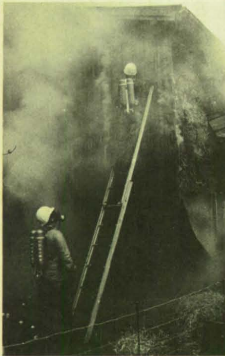
Unter schwerem Atemschutz befestigten die THW-Helfer die Greifzugseile an den brennenden Wand- und Deckenkonstruktionen. (Foto: Behrens)
