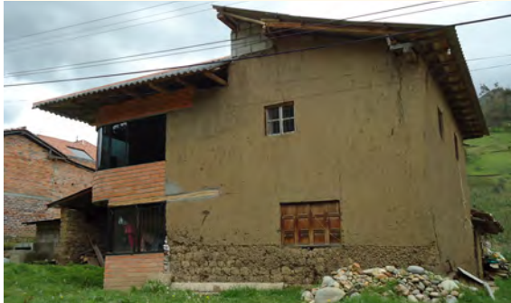
FOTO N° 3.1.12 Pérdida del patrimonio edificado.
