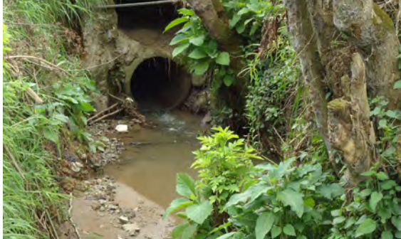
FOTO N° 3.1.7 Aguas residuales evacuadas en acequia.
