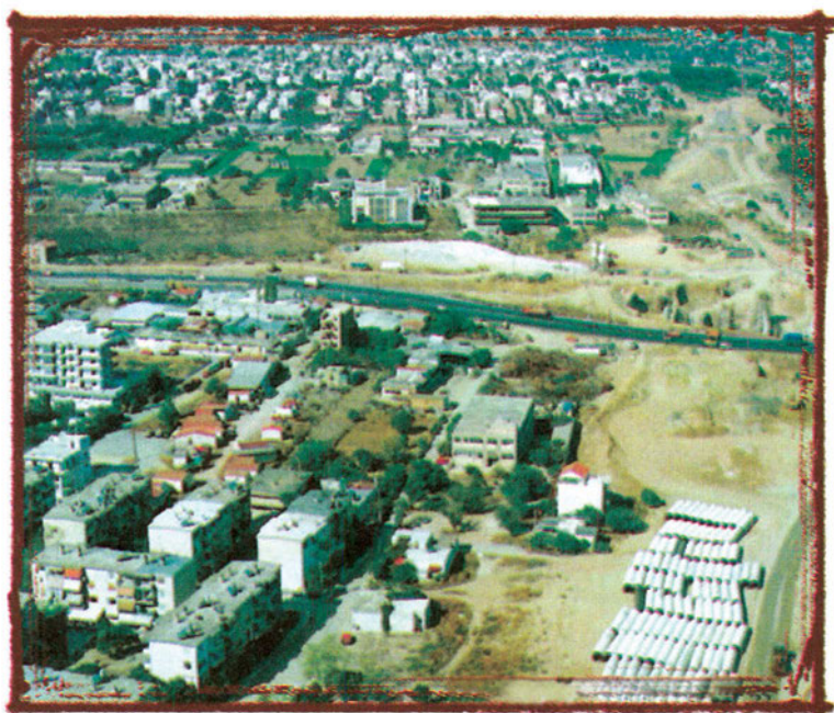
Εικόνα 76 Τα έργα για τη χάραξη ενός μεγάλου οδικού έργου και οι επιπτώσεις στη γύρω περιοχή πριν έλθουν και οι επιπτώσεις από την κυκλοφορία: Η νέα περιφερειακή οδός Σταυρού-Ελευσίνας στην Αττική. {21}
