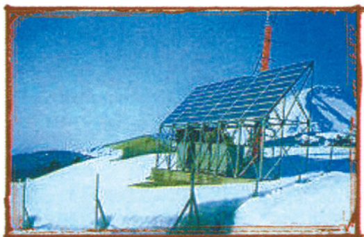
Εικόνα 118 Αυτόνομο Φ/Β σύστημα τηλεπικοινωνιών στο Όρος Δίρφη. [48]
