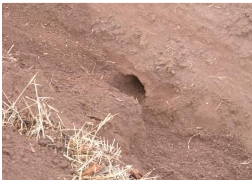
شکل 91-9- هدر رفتن آب از طریق سوراخ های موش
