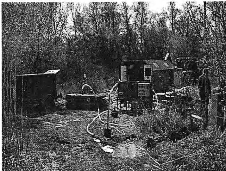
Zászlóalj típusú mobil víztisztító állomás telepítve
