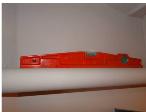
25. ábra Mágneses vízszintmérő csővezeték ellenőrzéséhez
