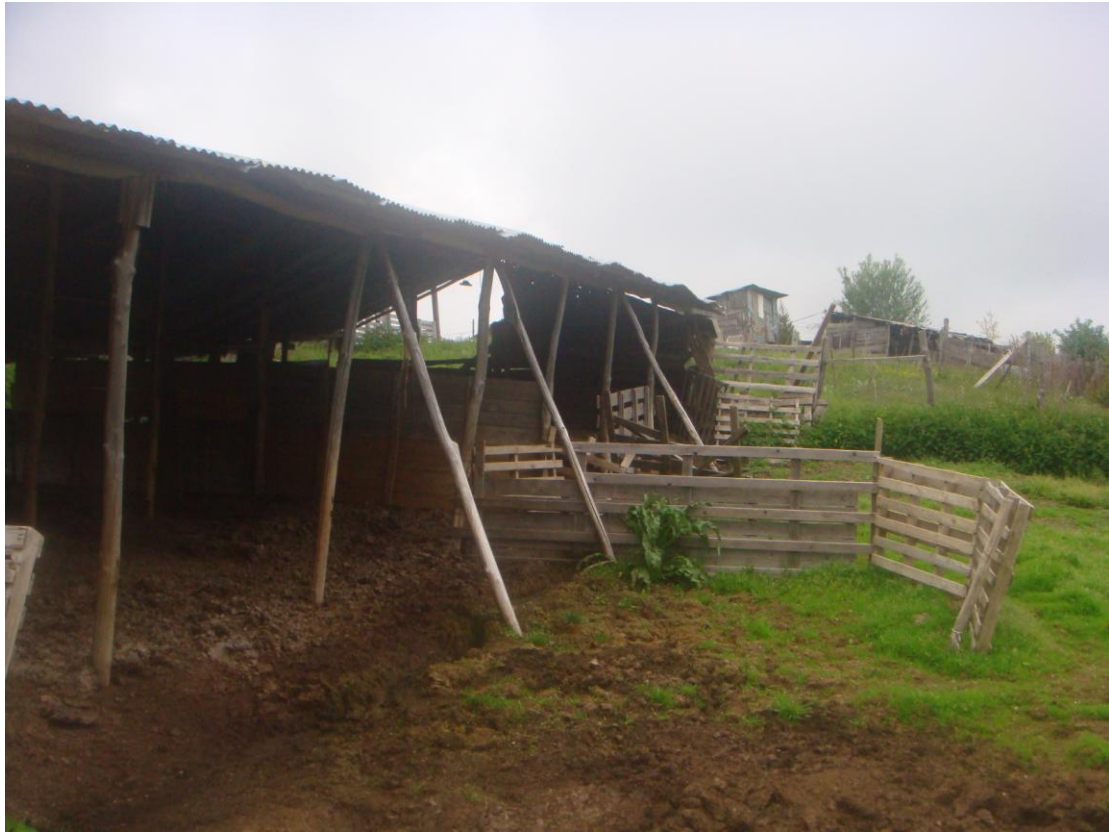
Εικ. 29. Σταβλικές εγκαταστάσεις κ. Κίρτσου στο Κάτω Βέρμιο (Σέλι) Βεροίας.
