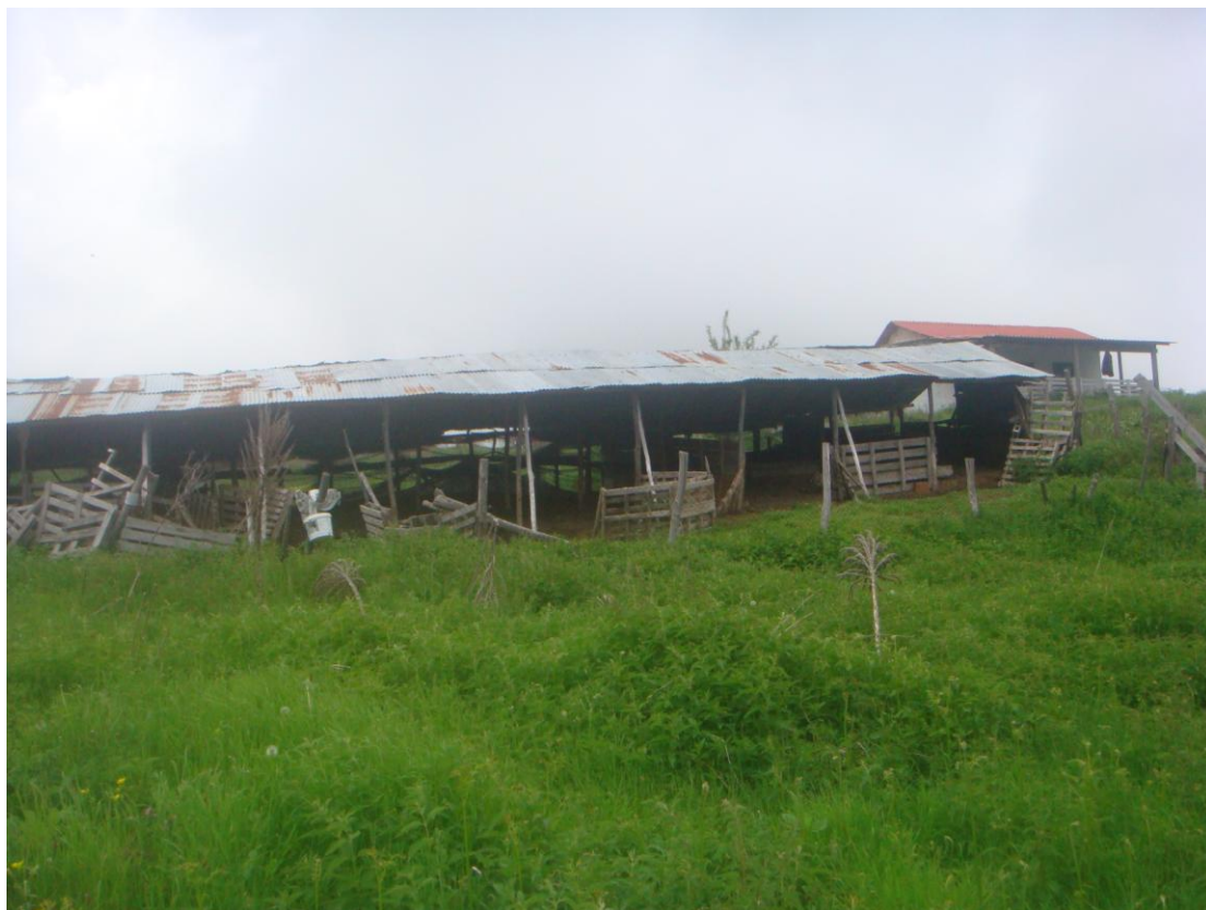
Εικ. 31. Σταβλικές εγκαταστάσεις κ. Κίρτσου στο Κάτω Βέρμιο (Σέλι) Βεροίας.
