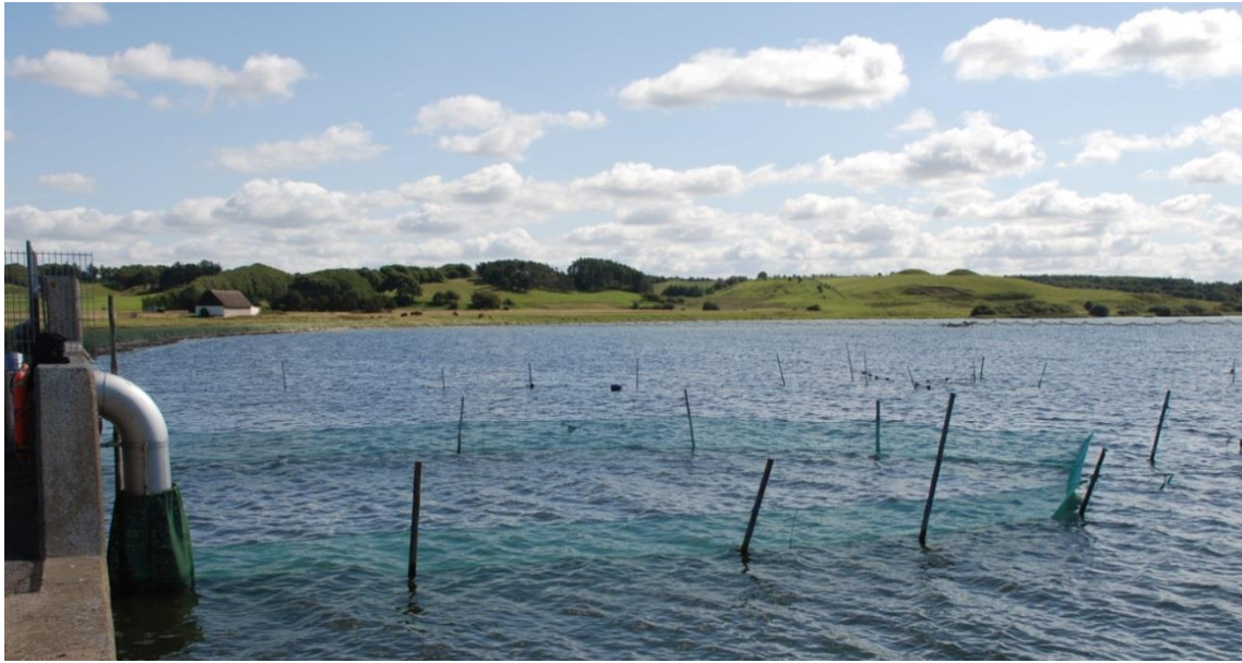
Figur 2-7 Til venstre ses rør fra finrist på pumpestationen med påmonteret opsamlingspose. Endvidere ses den halvbueformede opsætning af tobisnet omkring vandindtaget. Bagved ses pælerusen der er anvendt i forbindelse med moniteringen af fiskebestanden i nærområdet (Foto: Carsten Krog).
