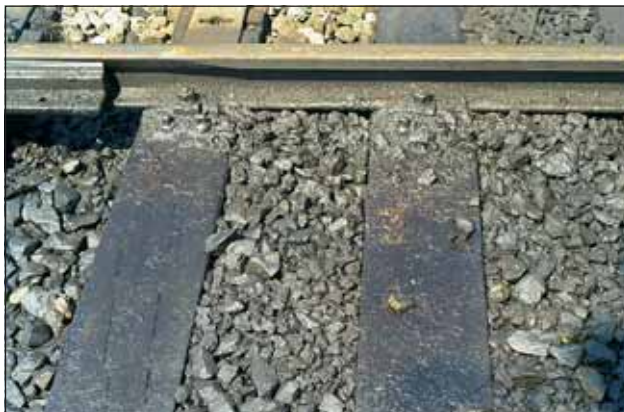
Abb. 5: Stark mit Öl verschmutzter Weichenbereich am Verschiebebahnhof Wels.
