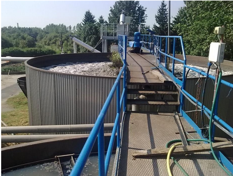
4. számú kép - Fehérgyarmat szennyvíztisztító telep - levegőztető műtárgy
