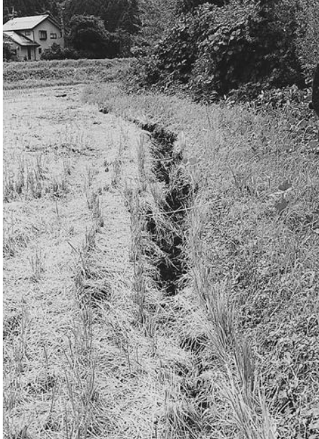
岩盤と表層堆積物との間に生じた亀裂。
