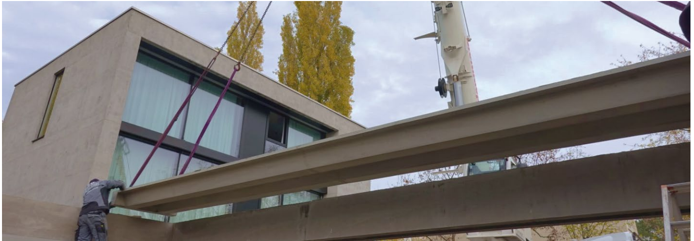
Bild 1 Montage einer Trapezplatte aus vorgespanntem Carbonbeton für eine Garage in Berlin, 2019 Assembly of a folded slab made of prestressed carbon concrete of a garage in Berlin, 2019
