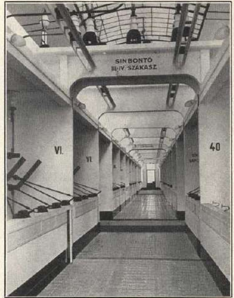
A sinterem közép folyosója a telep 30 KV-os kapcsolóházában
