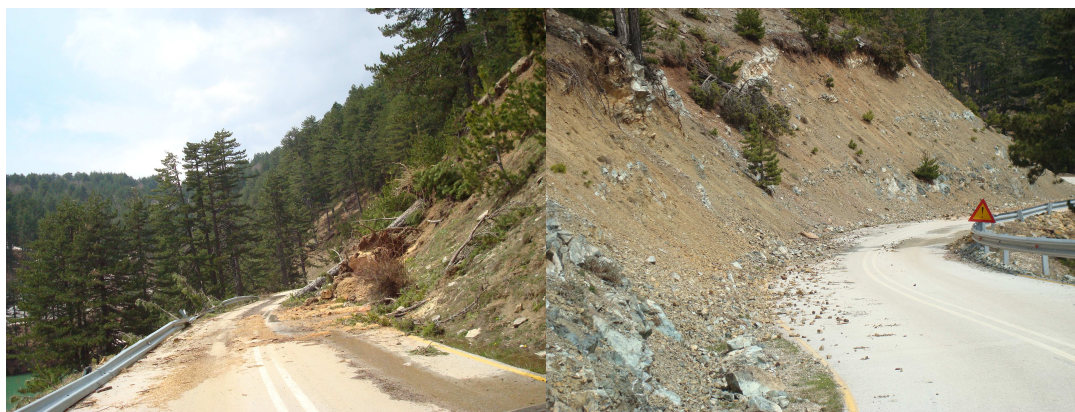
Φωτ. 15,16. Κατολισθήσεις στα πρηνή του δρόμου πλησίον της λίμνης (Τοπωνύμιο: «Κατσιώρα»)
