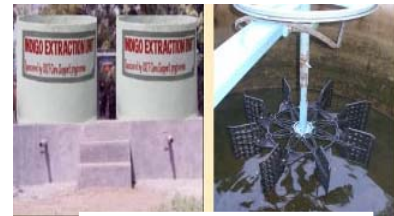
Δεξαμενή και αναμικτήρας
