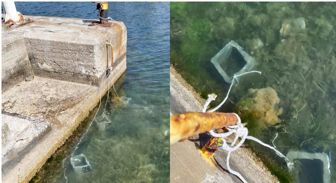
Εικόνα 13: Διαδικασία πόντισης – Δέσιμο κατασκευών στις δέστρες του λιμενοβραχίονα. Figure 13: Immersion process - Binding of the constructions on the bollards of the jetty.
