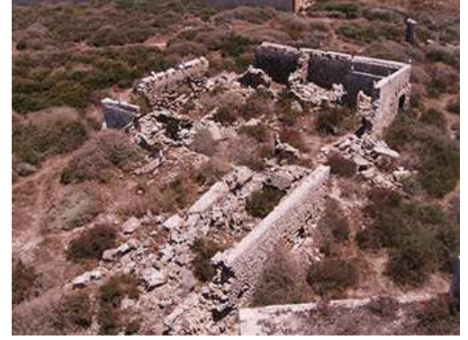
Figure 4 : les postes placés à coté des murs de la construction effondrée (station 2)
