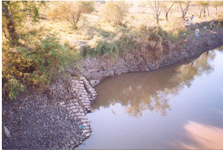
Figura 2.- Situación de la margen derecha, aguas arriba de la toma del Acueducto. Fotografía tomada en julio de 2007.
