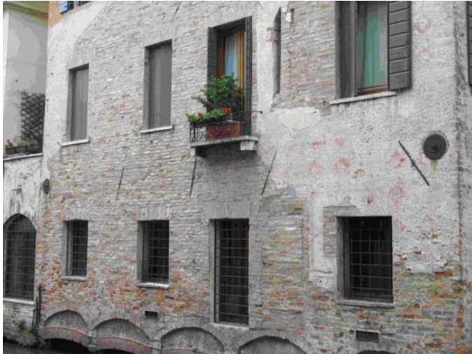
19. ábra. Vonóvasak erősítik a ház homlokzatát az épület átellenes falához. Földrengésben mérsékelten megsérült ház biztonsági javítása. Treviso, Olaszország. Fotó: Kázmér M., #1902.)
