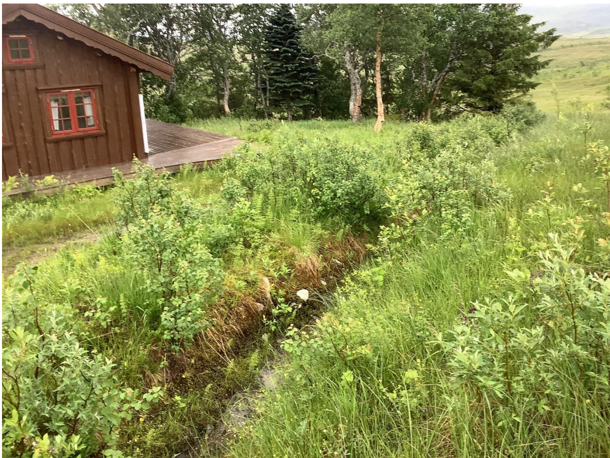
Figur 16. Inngrepene ved hytta i vest. Øverst: Kabelgrøfta vil trolig revegetere fint, men bør følges opp med jevne mellomrom da bekken som renner her kan tenkes å ta nytt løp og heller følge grøfta snarere enn sitt originale løp. Bildet er tatt like innenfor reservatgrensa. Nederst: Grøfta ved hytta ligger åpen og drenerer tilgrensende myr. I bakgrunnen skimter en også gran, både stedegen og antatt fremmed art av edelgran. En ser også deler av opparbeidet areal utenfor hytta. Foto: Solfrid Helene Lien Langmo.
