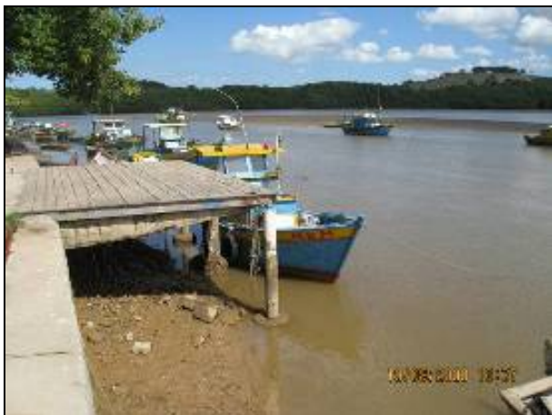
Figura 4.3.2.2.2-19: Cais da Colônia de Pescadores Z-4 demonstrando a precariedade do local e o assoreamento da calha do rio Benevente.
