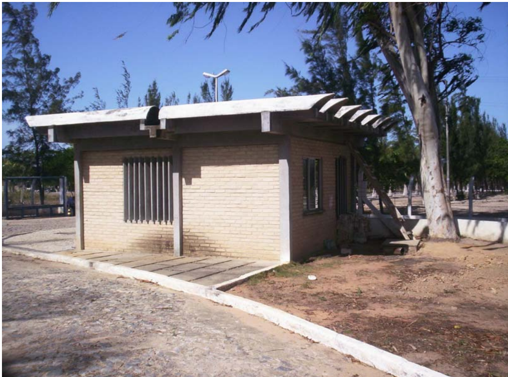
Foto 7.6 – Visão lateral da guarita NUTEC, Fortaleza, notando-se algum desgaste e sujeira na parede, necessitando manutenção (lavagem com água); não há pintura pois não é aconselhável; somente verniz seria a proteção melhor para as paredes, o que nunca foi feito nos mais de vinte de anos de construída (do autor).
