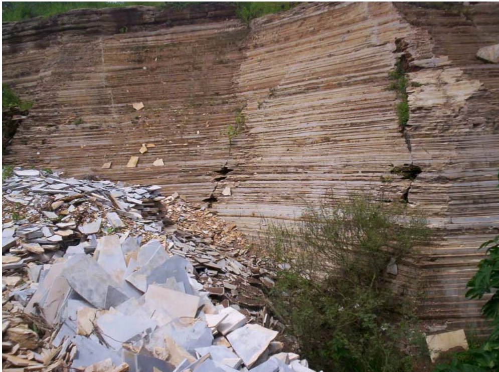
Foto 8.6 – Pedreira do Sérgio Major, afloramento 2, em Tatajuba, Santana do Cariri, com serviços dificultados pelo estreitamento da frente de mineração e com material quebrado e não aproveitável no meio da praça (do autor).
