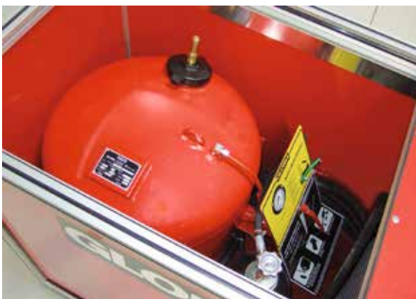
Feuerlöschcontainer von oben
