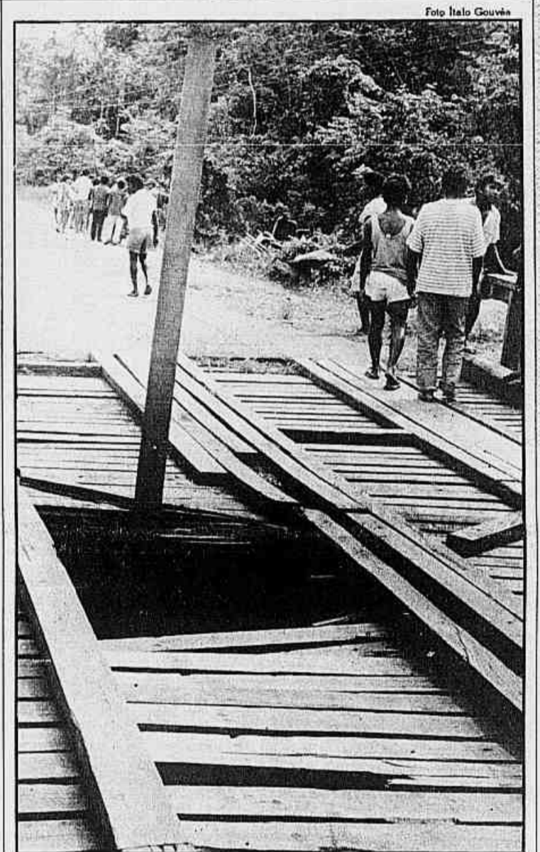
No meio da ponte, o buraco que fez o veículo des governar.
