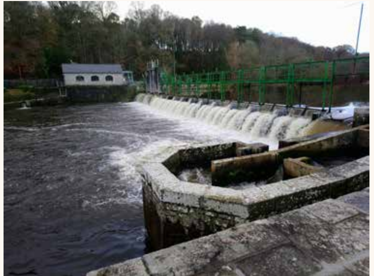
Le fonctionnement de la microcentrale remet en cause l'efficacité de la passe à poissons implantée sur la berge opposée
