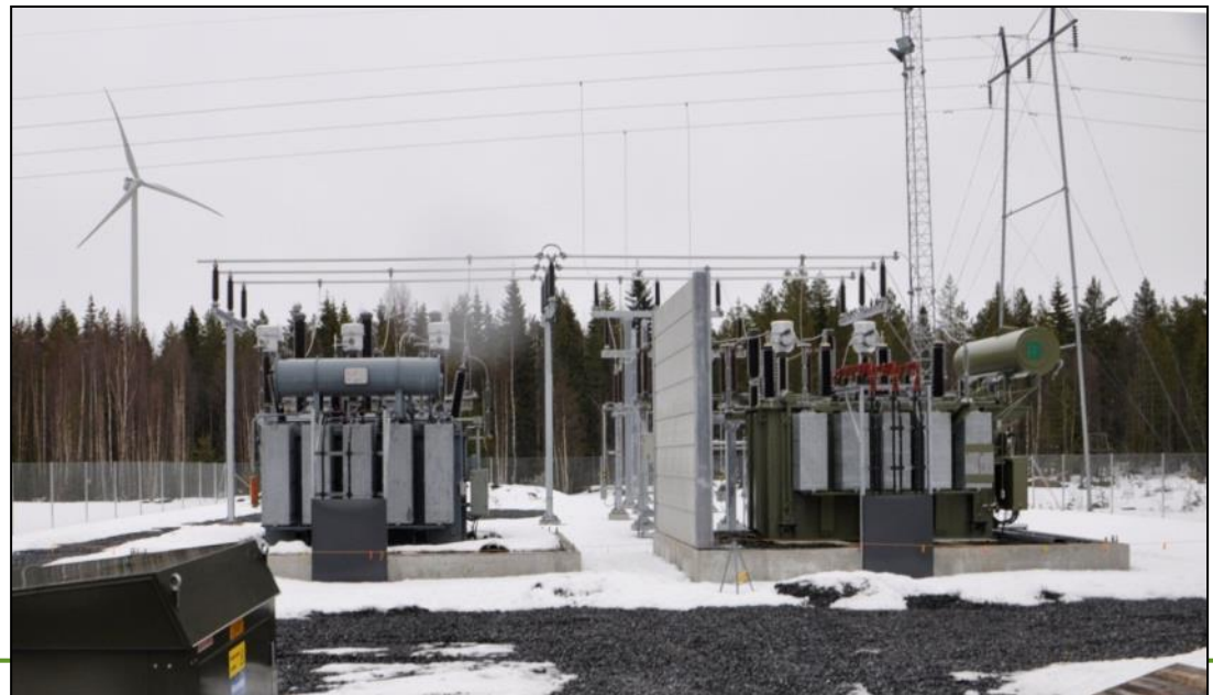
Figur: Exempel på en elstation i vindkraftsparken.
