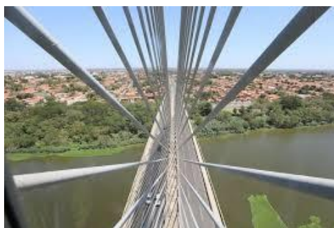
Figura 42 - Estais de sustentação das pistas de concreto da ponte Estaiada. Fonte: Portal oito e meia 138 .
