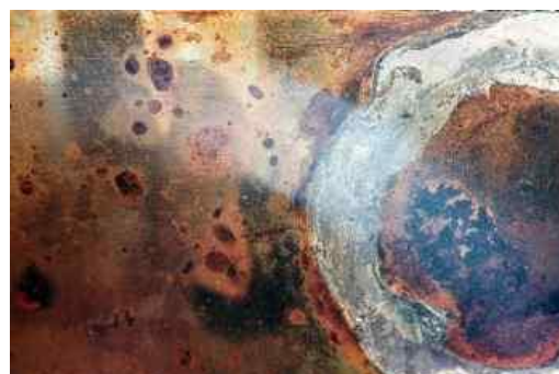
Lámina de metal oxidado
