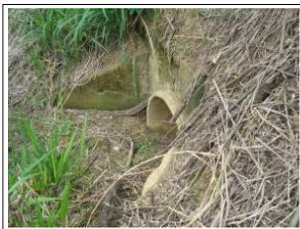
Fotografia 36. Detalhe do sistema de drenagem instalado sob leito da rodovia ES-245, que tem como objetivo permitir o livre fluxo hídrico entre a área da FLONA de Goytacazes a propriedade vizinha
