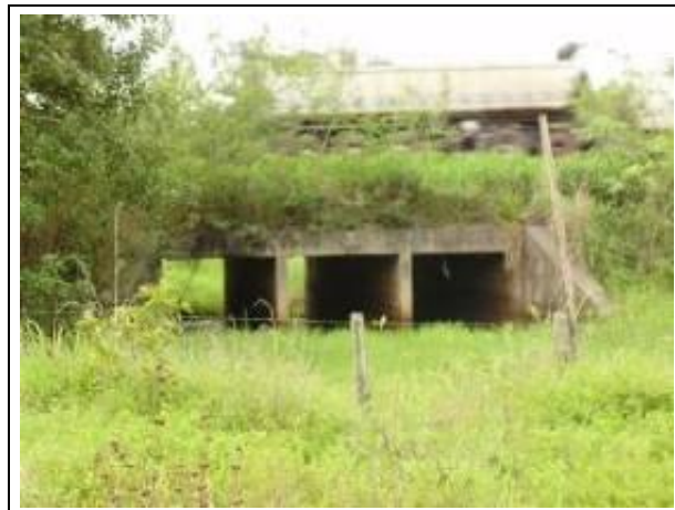
Fotografia 33. Observa-se a presença de pontilhão de concreto construído para dar vazão às águas pluviais sob a BR-101
