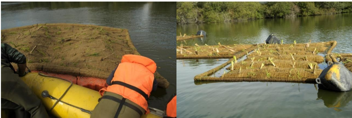
Figura 43. Depósito de las plataformas, unión entre ellas y anclaje en su ubicación final.
