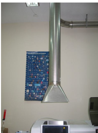
Foto 3.12: Campana de extracción
