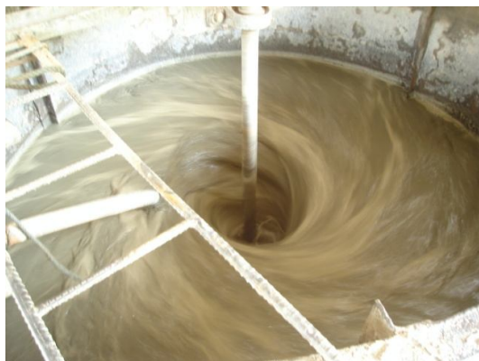
Foto 2.26: Tanque de cianuración
