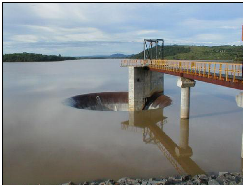
Figura 6.5 – Tomada d'água Barragem 1 (foto Jotalu)
