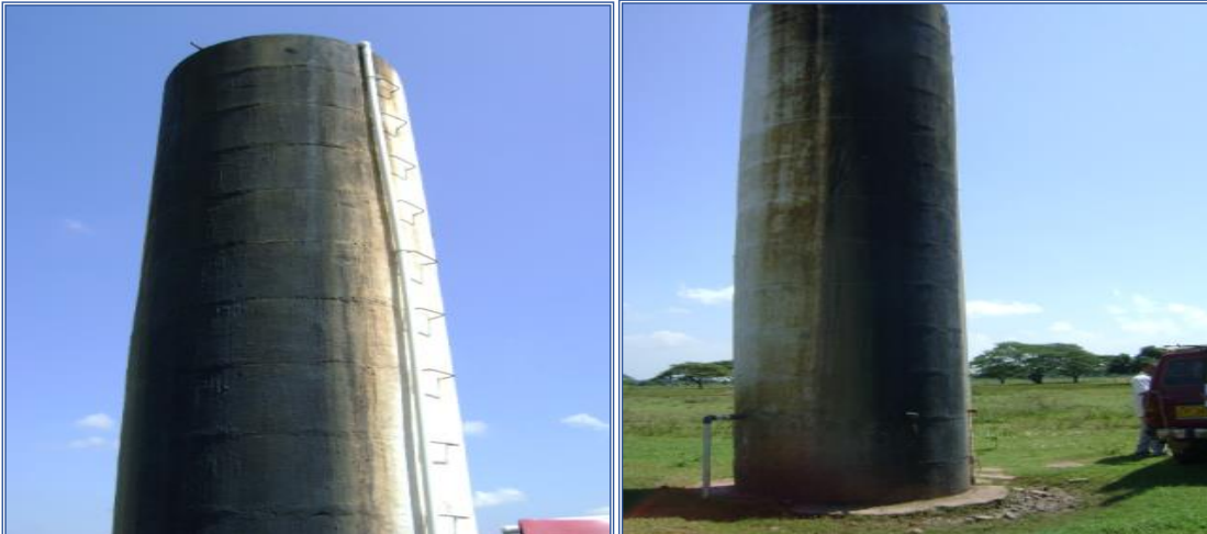
Foto. 3-2. Estación de bombeo y tanques de abastecimiento del Pozo El Guáimaro Fuente: POMCA Rio Chiriaimo
