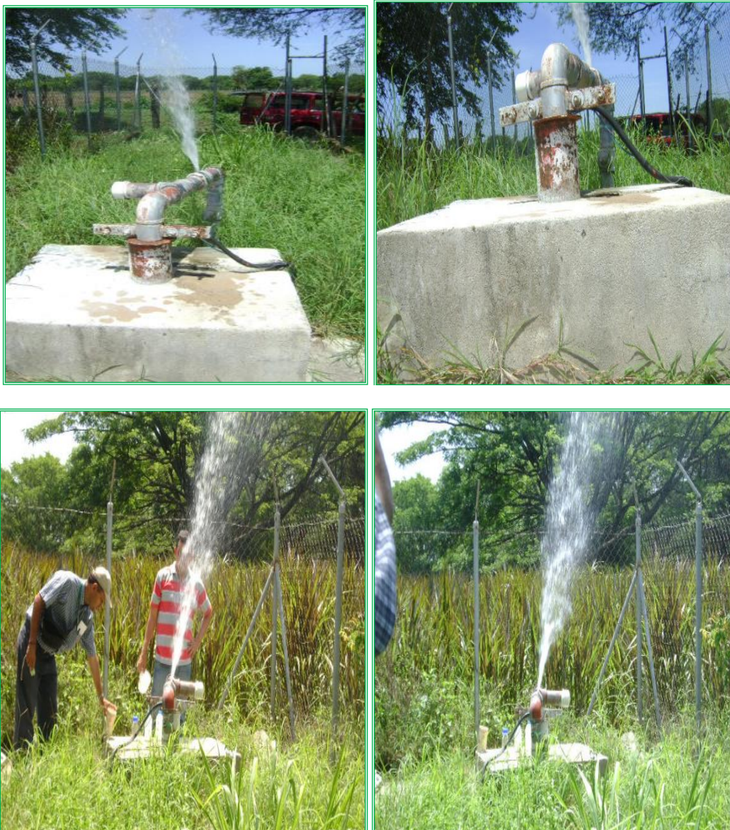
Foto. 3-9. Estación de bombeo del Pozo Varas Blancas
