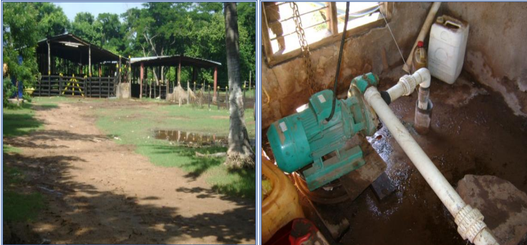
Foto. 3-1. Establos abastecidos por Pozo amazonita y estación de bombeo del mismo. Fuente: POMCA Rio Chiriaiimo
