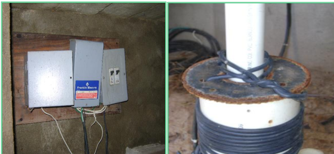
Foto. 3-5. Estación de bombeo y boca de Pozo Matúa Fuente: POMCA Río Chiriamo
