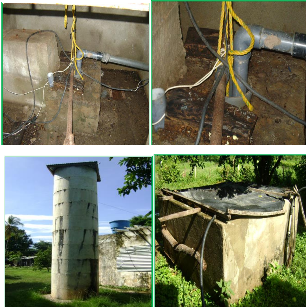
Foto. 3-7. Estación de bombeo y tanques de abastecimiento del Pozo Santa María.
