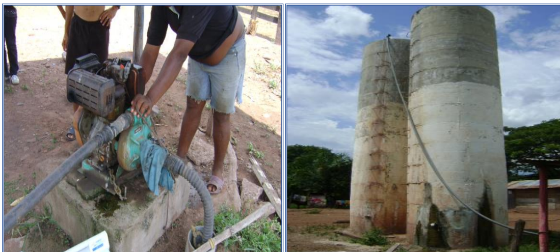
Foto. 3-4. Estación de bombeo y tanques de abastecimiento del Pozo Mazatlán
