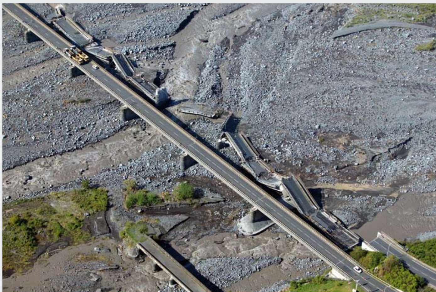
Figure 173 Pont de la Rivière Saint-Etienne écroulé après le passage du cyclone Gamède
