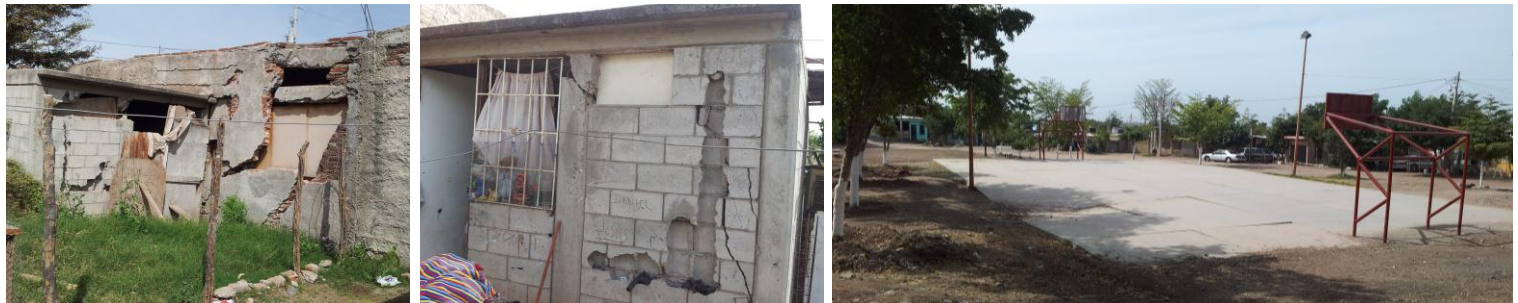
Imagen 30. Daños causados a las viviendas y el equipamiento por el hundimiento del suelo .
